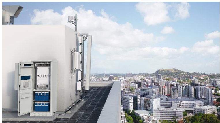
Figur 20: Ericsson Radioutrustning på hustak. Källa: Ericsson
